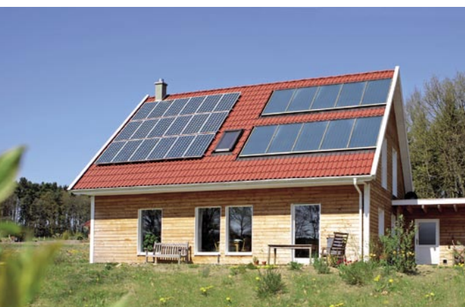
Kombi-Solar wärmt Wasser und unterstützt die Heizung
