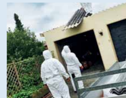
Asbest und Co. sind eine Gefahr für die Wohngesundheit
