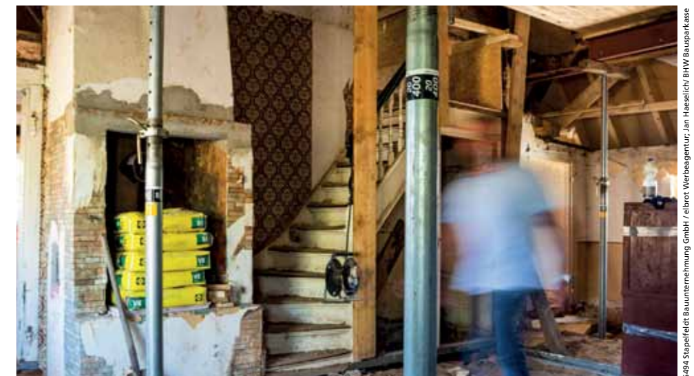
Keine Seltenheit bei der Altbauanierung – schadstoffbelastete Baumaterialien
