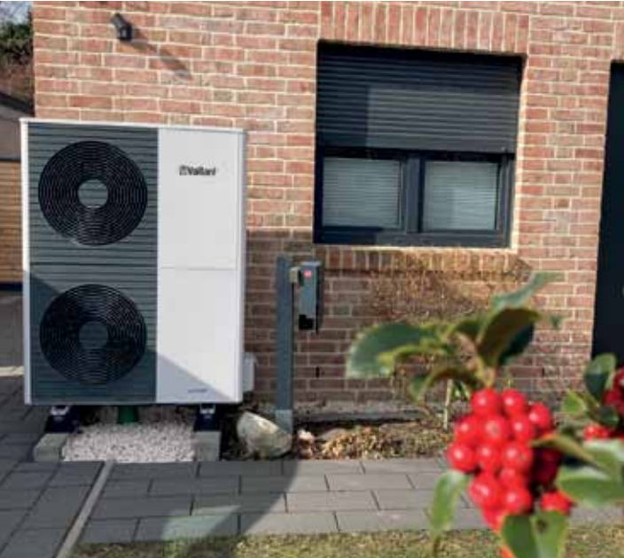
Eine gute Investition, weil klimafreundlich: Wärmepumpen
