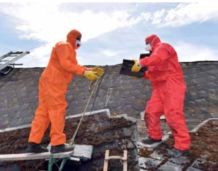
Bis 1992 verwendet, jetzt ein Fall für den Sondermüll: Asbestzement
